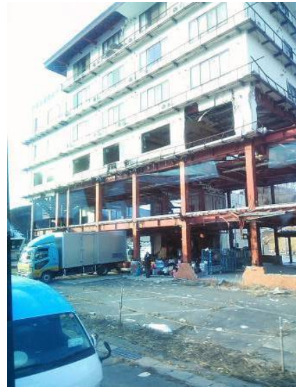
図4：被災したホテル
